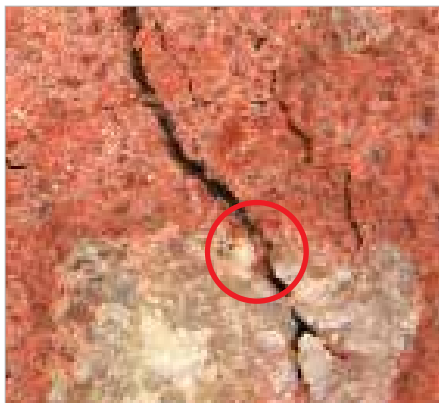
Trhlina na povrchu betónu
