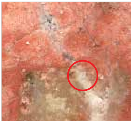
Uzavretie trhliny v dôsledku autoreaktívneho účinku v betóne
