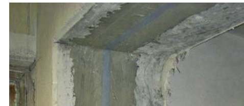
Dilatačná škára v podzemnej garáži, dodatočne utesnená lepiacim systémom INDUBOND-Tape-3000
