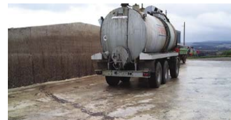
Korózia konštrukcie silážnej nádrže vplyvom pôsobenia silážnych štiav
