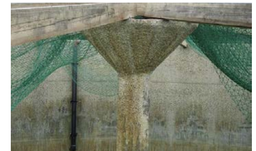
Korózia konštrukcie nádrže v bioplynovej stanici vplyvom pôsobenia biogénnej kyseliny sírovej
