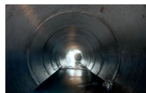
Notekūdeņu kanāli un šahtas
