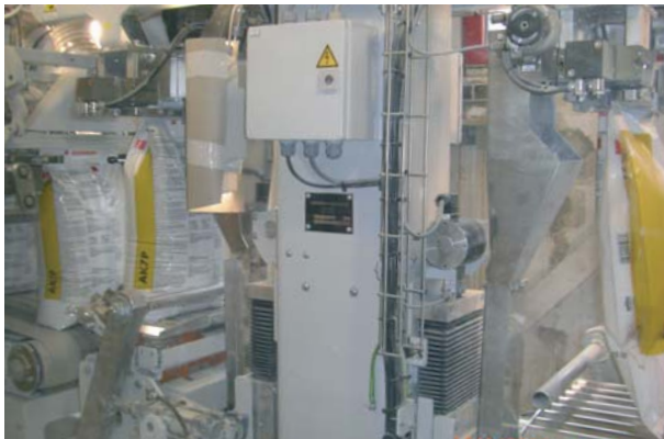
Die Trockenmörtelprodukte, wie hier der Flexkleber AK7P, werden seit Januar 2009 über eine neue Maschinenteknik in PE-Folien-Säcken abgefüllt.
