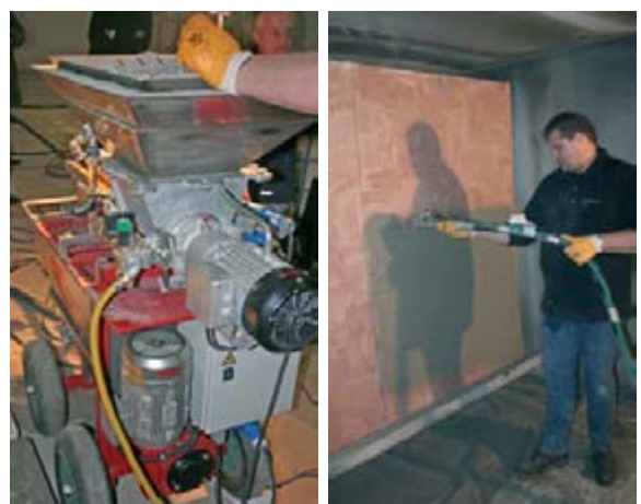
Betoninstandsetzung im Spritzverfahren über eine Strecke bis zu 40 m Schlauchlänge – eine neu entwickelte Maschine mit besonderem Misch- und Förderaggregat macht dies möglich.
