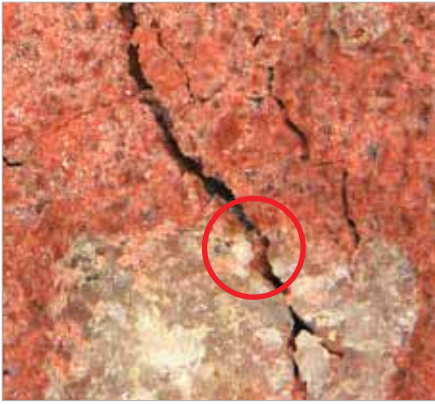
vznik trhlin v betonu
