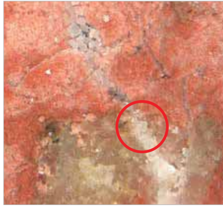
uzavření trhlin v důsledku auto-reaktivního efektu po šetření betonu
