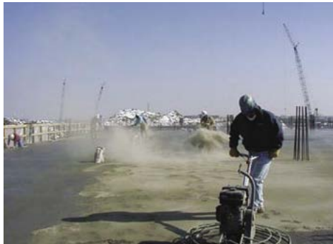
Aplikace AQUAFINu-IC vsypem do mladého betonu, s následným zapracováním pomocí rotačních hladíček
