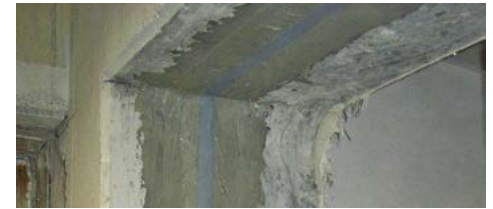
Dilatační spára v podzemní garáži, dodatečně utěsněná lepicím systémem INDUBOND-Tape-3000
