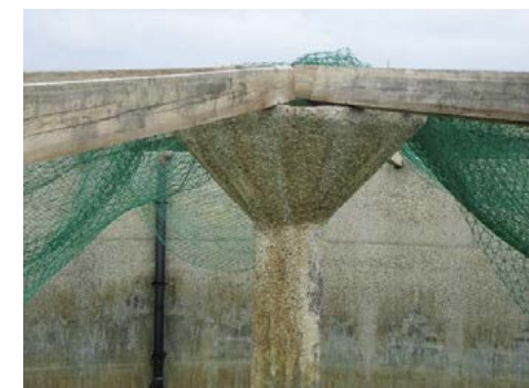
Koroze konstrukce nádrže v bioplynové stanici vlivem působení biogenní kyseliny sírové
