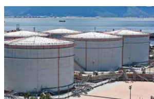
Nádrže a kontejnery
