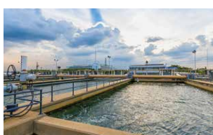
Sběrné a retenční nádrže
